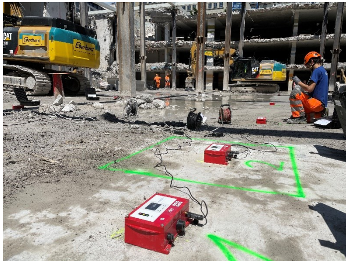
Abbildung 2: Installation der Messgeräte
