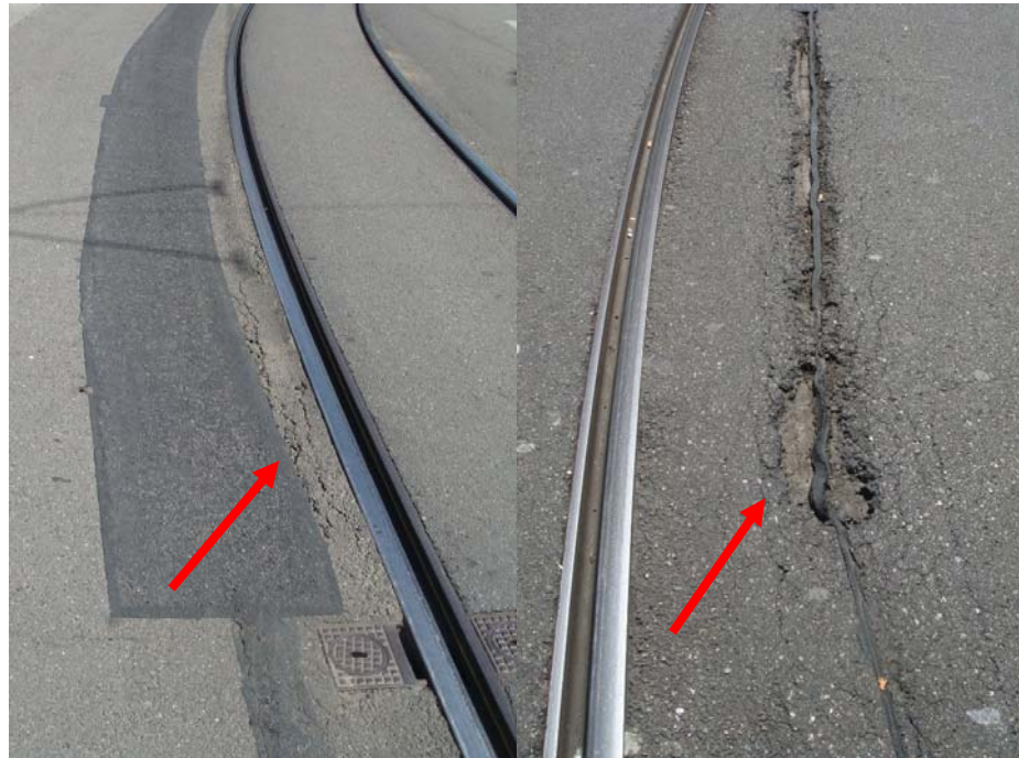
Bild 1: Belagsschäden bei Fugen, die bis zur Oberfläche reichen. Links: Fuge mit Bitumen ausgegossen; rechts: Fuge im Belag ohne besondere bauliche Massnahmen. Zustand nur wenige Jahre nach Inbetriebnahme der entsprechenden Gleise, in einer anderen Stadt.
