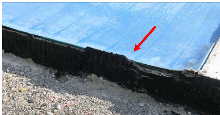
Bild 15: Die stärkste bituminöse Körperschallbrücke wurde beim MFS C1 vorgefunden; diese dürfte die unerwartet hohen Messwerte für die Eigenfrequenz erklären.
