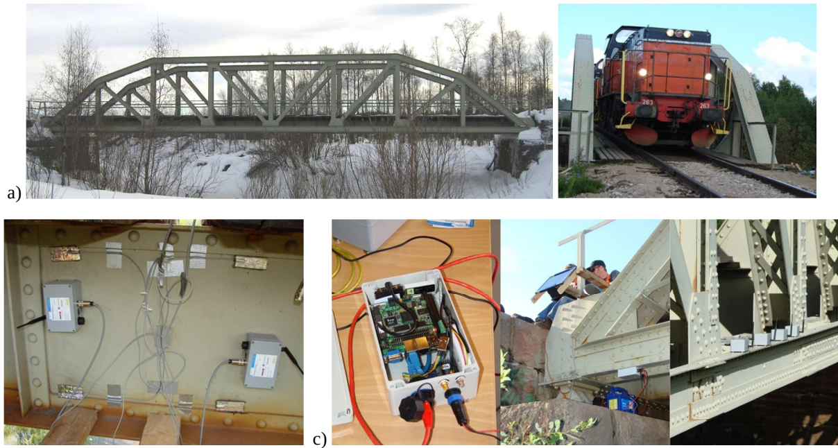
Abb. 6: a) Eisenbahnbrücke. b) Auf einem Stahlträger montierte Dehnmessstreifen mit Sensorknoten. c) Basisstation (links); Energieversorgung der Basisstation mit Autobatterien und Photovoltaik-Panel (Mitte); Sensorknoten auf dem Längsträger.
