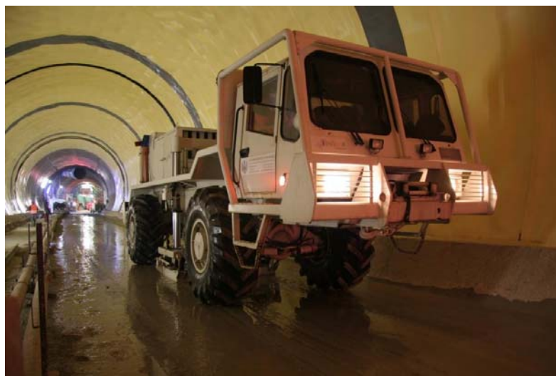
Abb.4: VibroScan.at Schwingungsgenerator im Weinbergtunnel, Zürich
