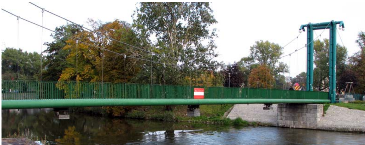
Abb. 1: Fussgängerbrücke mit drei Schwingungstilgern zur Bedämpfung der 1. und 2. Eigenschwingung.
