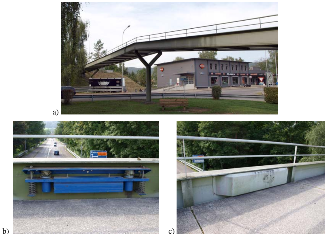
Abb. 6: a) Fussgängerbrücke über die Kantonsstrasse. b) Im Längsträger eingebauter Schwingungstilger. c) Abdeckung des Tilgers.
