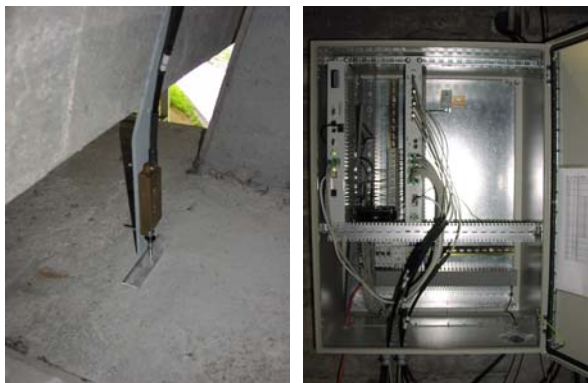
Bild 4: Anordnung der Sensoren in der Bergspur, Fahrtrichtung Süd Fotos: Extensometer und Messschrank
