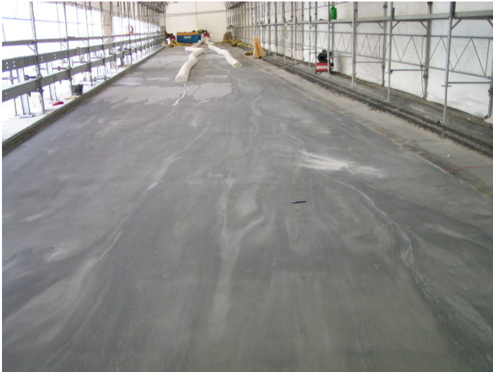
Abb. 3-1 Schadensbild grossflächige Modulausscheidungen bei der Ledischleifbrücke (Oktober 2003)
