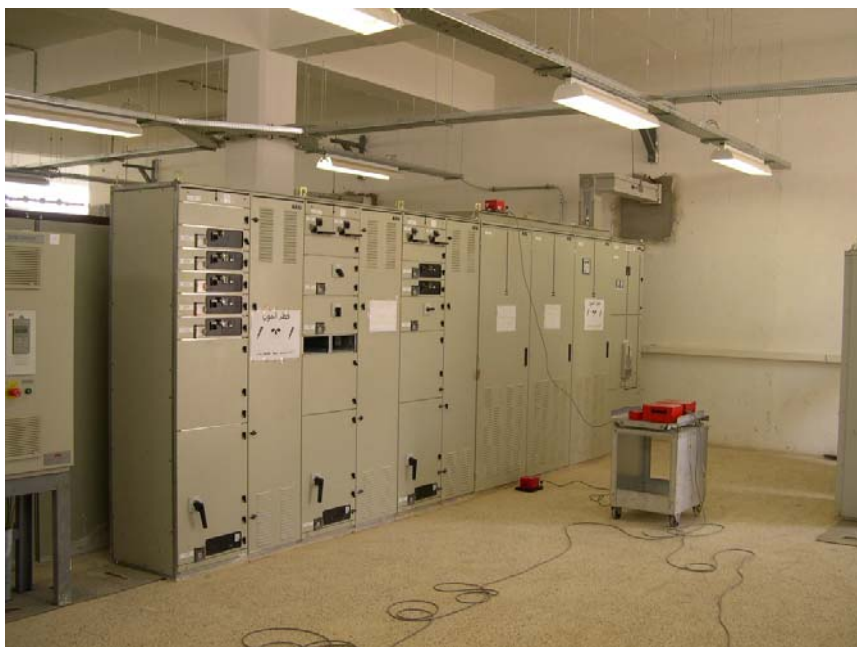
Bild 4: Steuerschränke in der Unterstation Es wurden die Vibrationen der Decke über UG und die Vibrationen auf den Steuerschränken gemessen. Dabei wurden Resonanzfrequenzen der Decke zwischen 15 und 20 Hz beobachtet. In der Unterstation lag keine homogene Decke vor. Da die Steuerschränke von unten her angeschlossen werden, sind breite Schlitz in die Decke geschnitten. Die Decke im Bereich der Schränke besteht somit nur aus einer Reihe von Balken.
