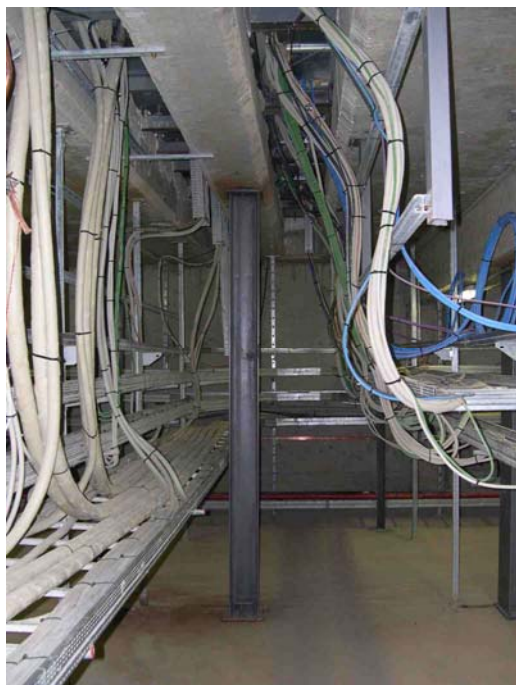
Bild 6: Beispiel einer nachträglich eingebauten Stahlstütze im Untergeschoss der Unterstation Gut ersichtlich ist, wie aufgrund der Schlitz unter den Steuerschränken nur noch Balken verbleiben.
