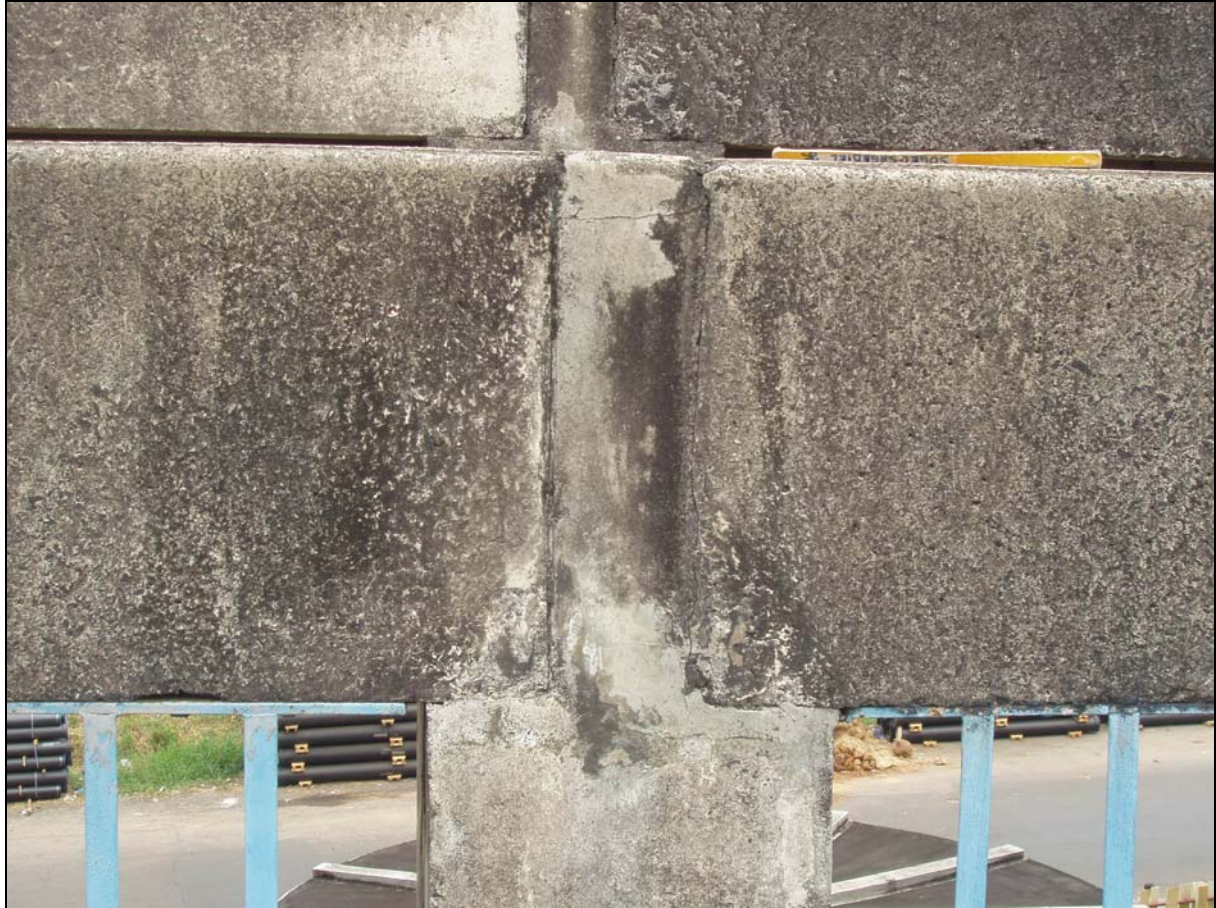
Abbildung 4 Beschädigte und geflickte Auflager der Stufen im Stadion Libreville
