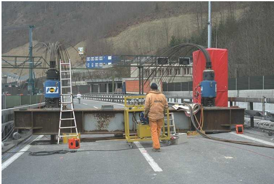
Abb. 13: Stahlträger zur Umlagerung der Kräfte von den zwei Pressen auf die Brückenstege.
