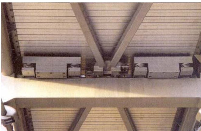
Bild 9.14a Schwingungstilger mit geringer Bauhöhe in der Millenium-Brücke in London
